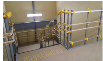
仮設部材を使用した手摺
