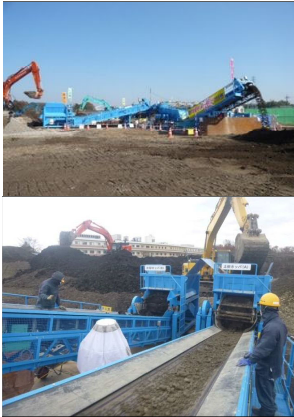
写真2 万能土質改良システム全景写真
