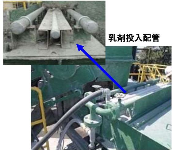
写真-7 乳剤投入配管
