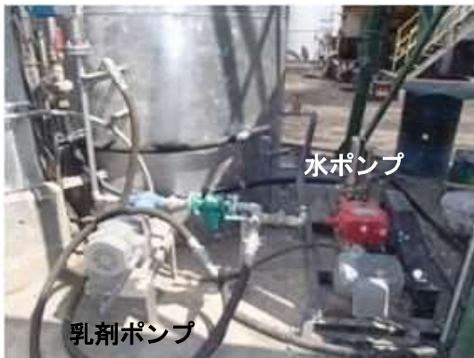
写真-6 インバーター制御ポンプ
