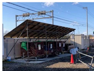
【写真7】産業廃棄物分別ヤード全景
